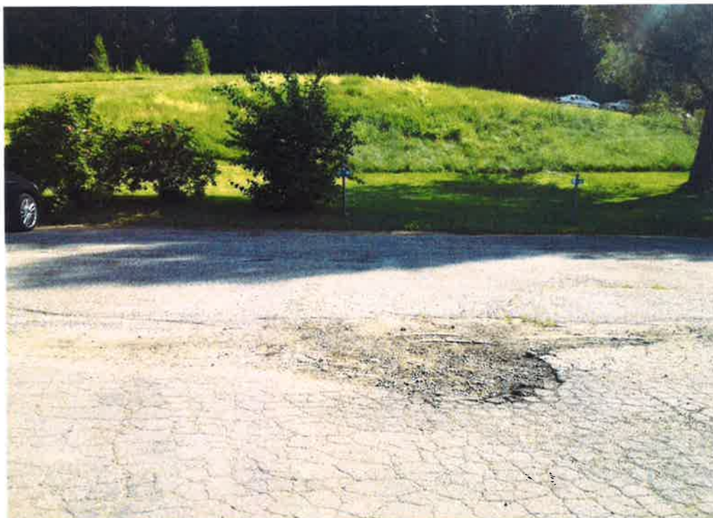
Bild 1. Slitage, åldring, sprickbildning.
