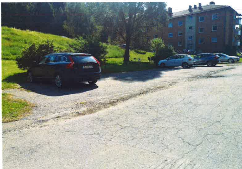
Bild 2. Slitage, åldring, sprickbildning.
